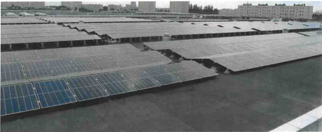
Panneaux photovoltaïques type SOPREMA posée en toiture de l'entrepôt orientés nord/sud et inclinés à 10°
